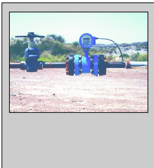
Equipo instalado en un yacimiento petrolífero en Tupungato, Pcia. De Mendoza
